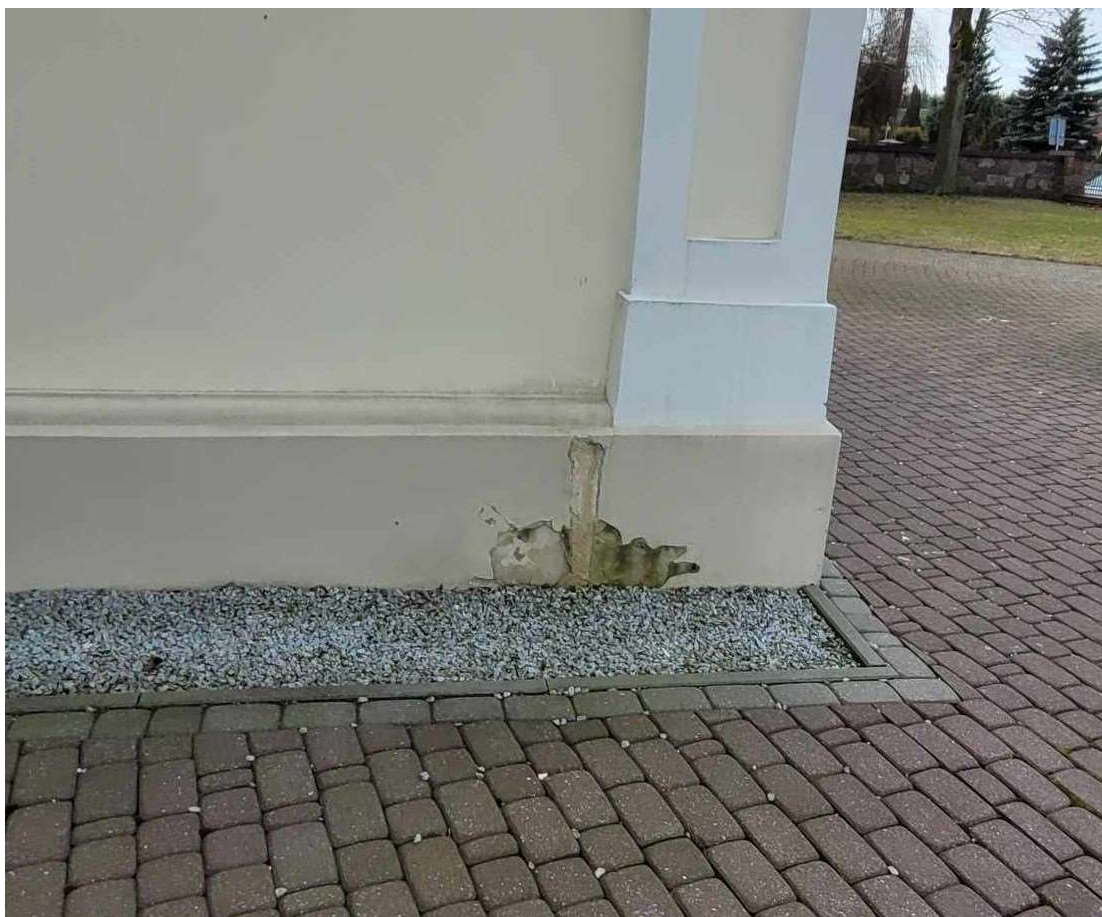
Zdj. nr 4 – Zawilgocenie i zagrzybienie elewacji – miejscowa degradacja cokołu.
