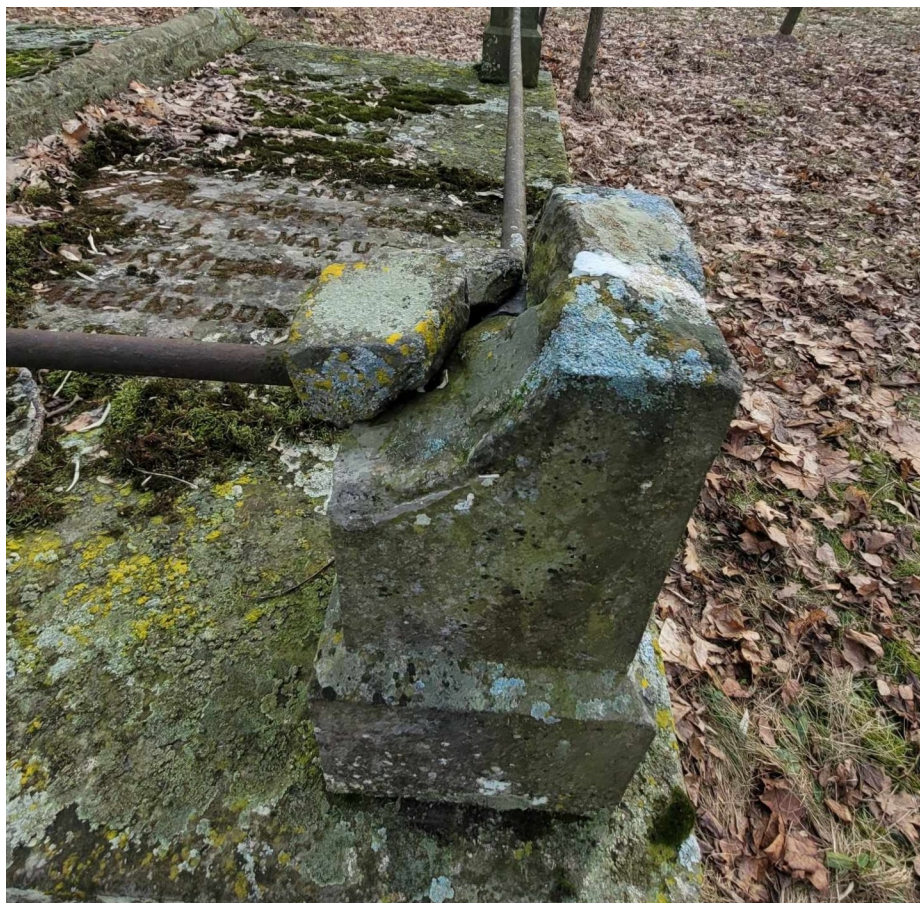
Zdj. nr 3 – Widok postępującej degradacji słupków ogrodzenia nagrobka Franciszka Gostowskiego.
