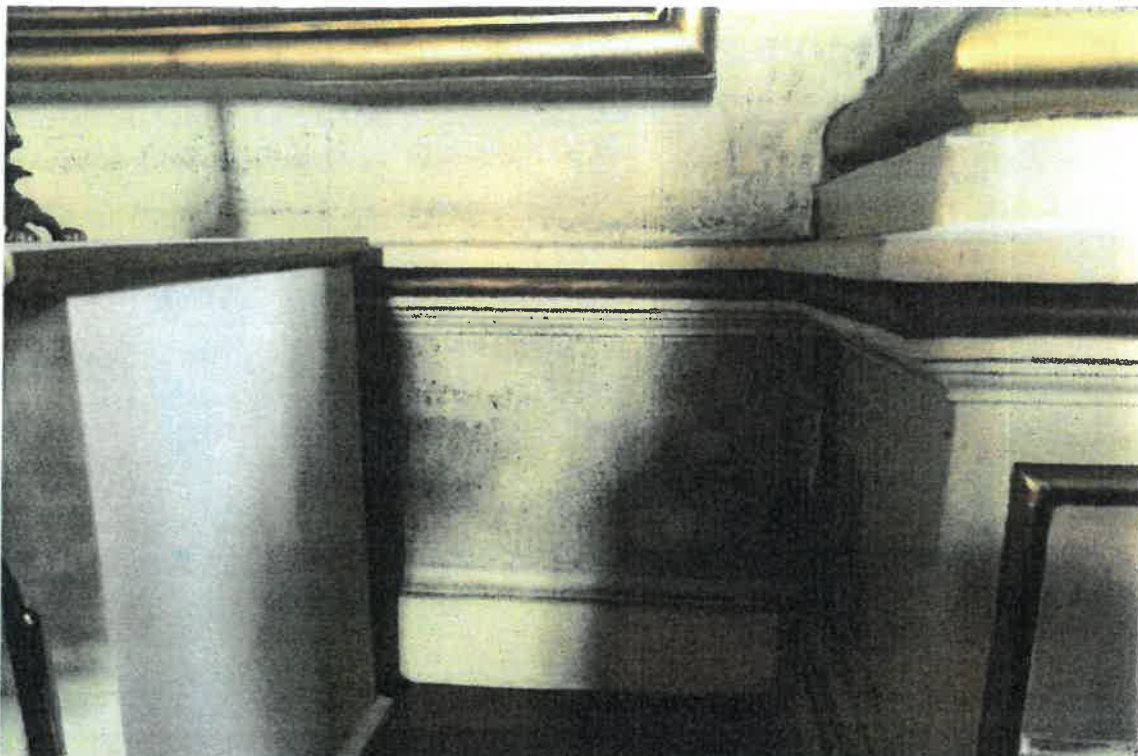
Il. 6 Grzyb na ścianie poniżej obrazu.
