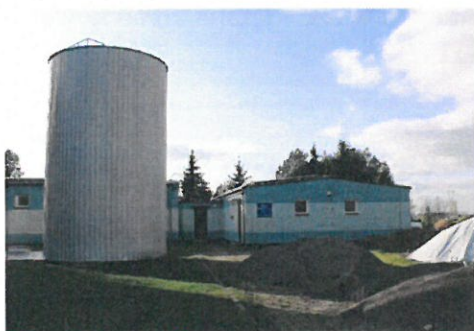
Stacja uzdatniania wody w Nowych Piekutach
