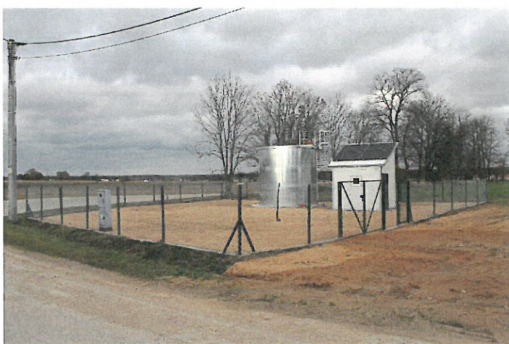
Przepompownia wody pitnej wraz z instalacją fotowoltaiczną w Skłodach Przyrusach
